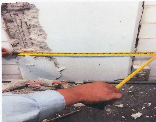
Fotografía 2.22 Espaciamiento de estribos de 30 cm. Concreto de dudosa calidad, su agregado grueso no se identifica con claridad.
