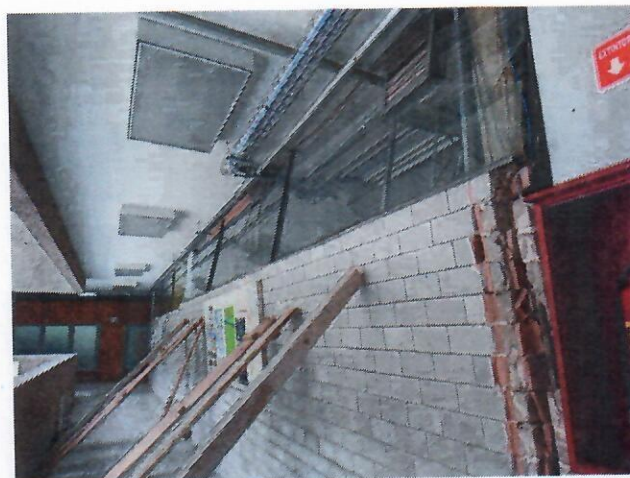
Fotografía 2.4 UNIDAD IZTAPALAPA, septiembre 2017, afectaciones del edificio "S". desplomes de muros de barroblock, México.
