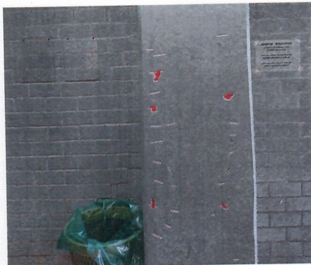
Fotografía 2.10 UNIDAD IZTAPALAPA, septiembre 2017, afectaciones del edificio "S". fractura en columna de concreto armado, México.
