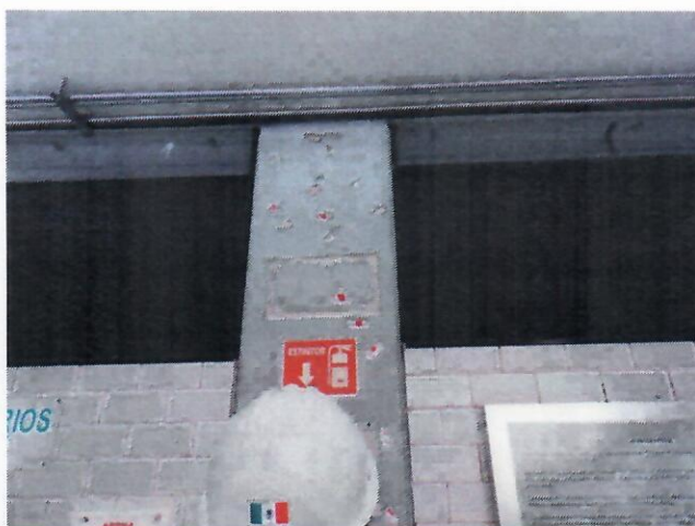
Fotografía 2.28 Columna de concreto con daño por efecto sísmico denominado columna corta.
