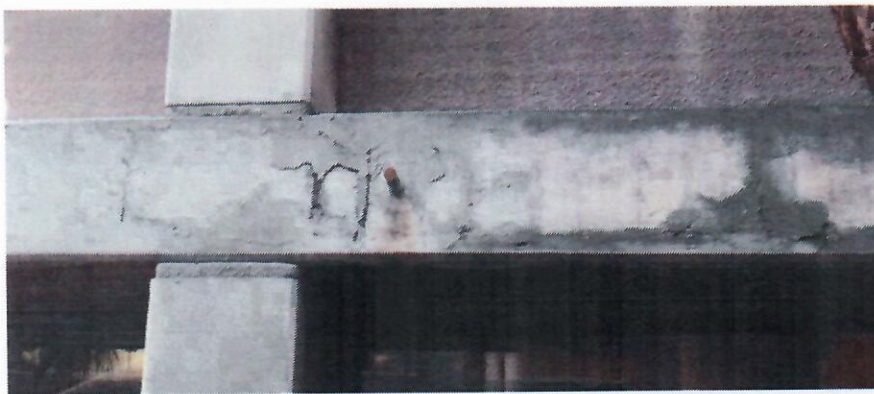
Fotografía 2.31 Acero expuesto en losa de fachada
