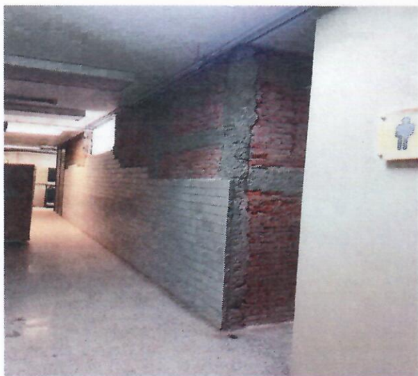
Fotografía 2.33 Daños en acabados de muro.
