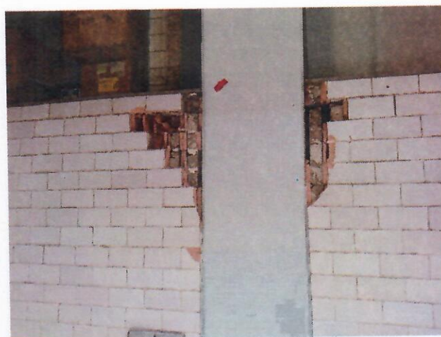
Fotografía 2.2 UNIDAD IZTAPALAPA, septiembre 2017, afectaciones del edificio "S". fractura de muro de barroblock y fisura en columna de concreto armado, México.
