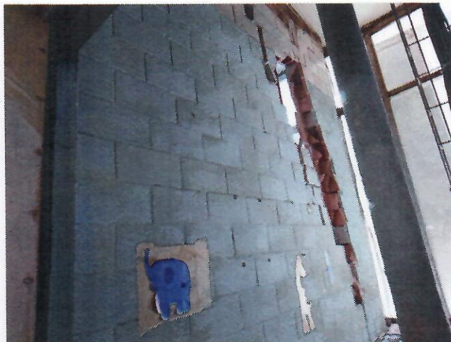
Fotografía 2.6 UNIDAD IZTAPALAPA, septiembre 2017, afectaciones del edificio "S". fractura de muros, México.
