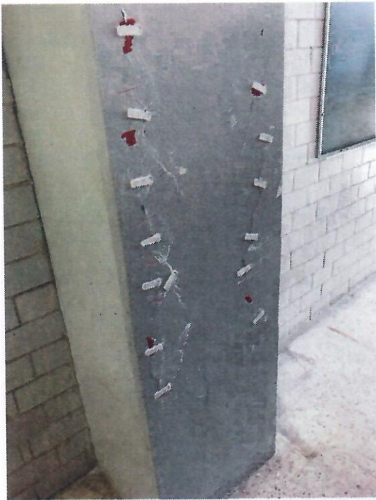
Fotografía 2.29 Fisuras en columnas de concreto armado.
