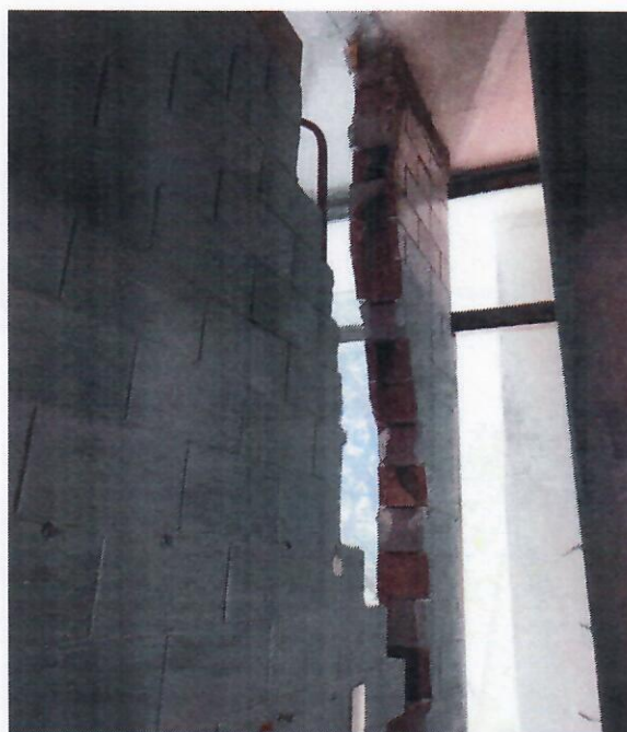
Fotografía 2.34 fallas en muros de mampostería divisorios.
