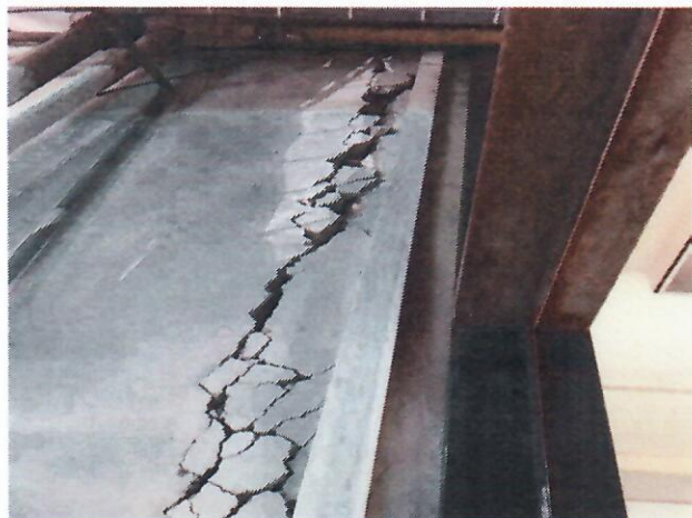
Fotografía 2.23.- Agrietamientos en acabados
