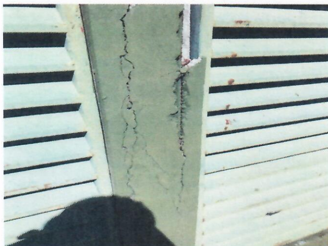
Fotografía 2.25 Agrietamientos en castillos de cuarto de máquinas en azotea.
