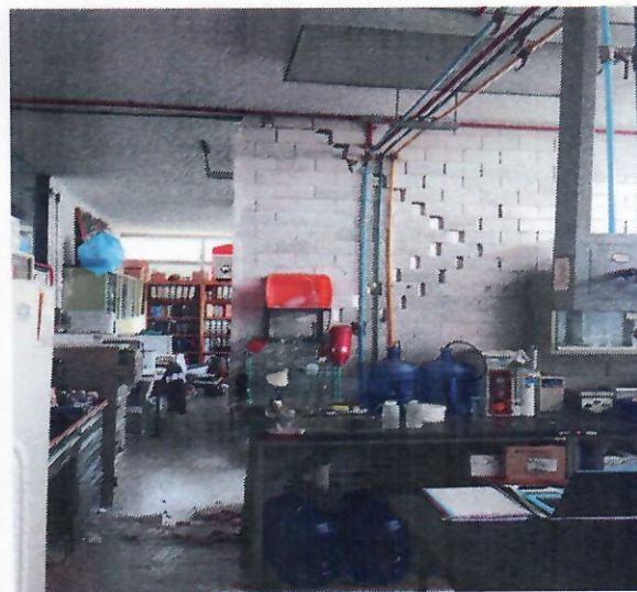
Fotografía 2.8 UNIDAD IZTAPALAPA, septiembre 2017, afectaciones del edificio "S". fractura de muro divisorio, México.
