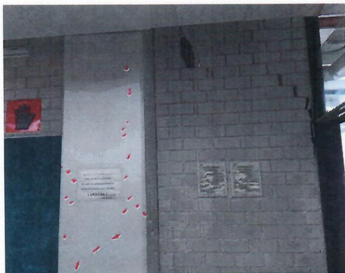
Fotografía 2.7 UNIDAD IZTAPALAPA, septiembre 2017, afectaciones del edificio "S". fractura de muro divisorio, fractura de columna de concreto armado, México.
