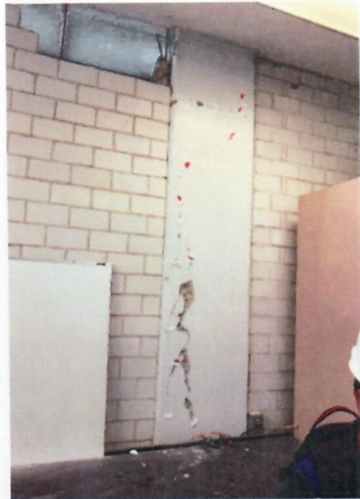
Fotografía 2.30 Fisuras en columnas de concreto armado.
