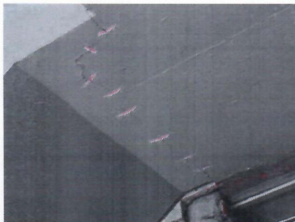
Fotografía 2.24.- Agrietamientos en losa de arribo de escaleras.
