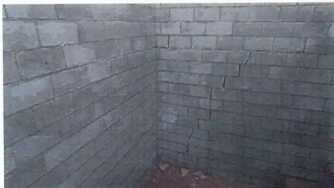
Fotografía 2.19 UNIDAD IZTAPALAPA, septiembre 2017, afectaciones del edificio "S". fracturas diagonales en muros de barroblock, México.
