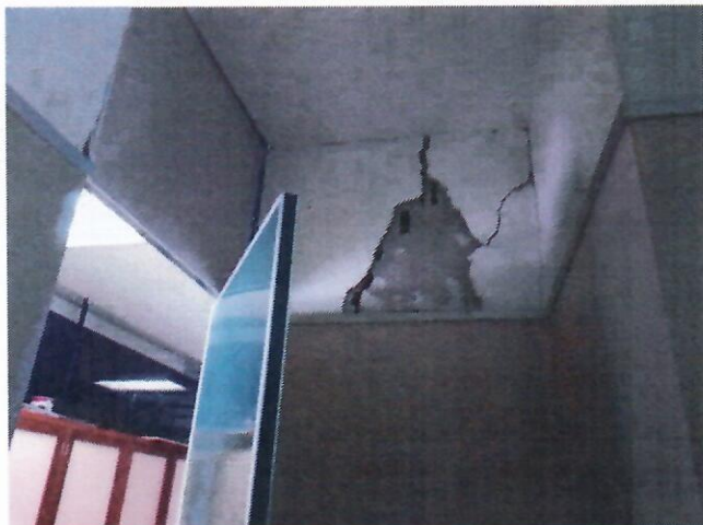
Fotografía 2.5 UNIDAD IZTAPALAPA, septiembre 2017, afectaciones del edificio "S". fractura de muros, México.
