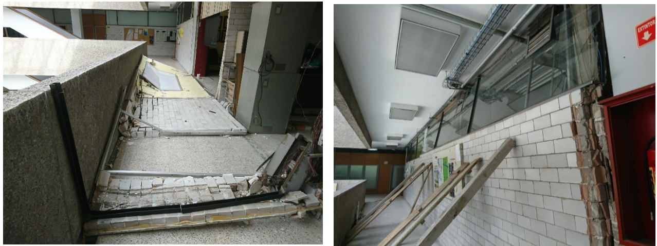
Imágenes de daños causados por el sismo de septiembre de 2017 en el edificio S de la Universidad Autónoma Metropolitana, Unidad Iztapalapa.
