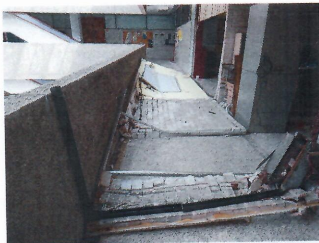
Fotografía 2.3 UNIDAD IZTAPALAPA, septiembre 2017, afectaciones del edificio "S". muros caídos de barroblock, daño en columna de concreto armado, México.
